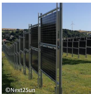
Panneaux bifaciaux verticaux
